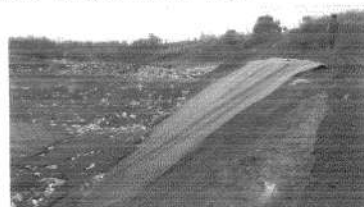
Foto 46: Aterro sanitário - manta de PEAD.
